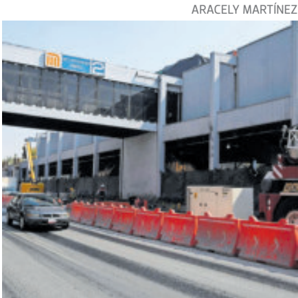
La estación de la L2 no dará servicio hasta nuevo aviso.
